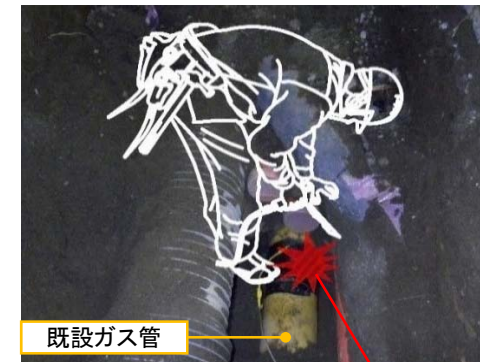
事故発生状況
