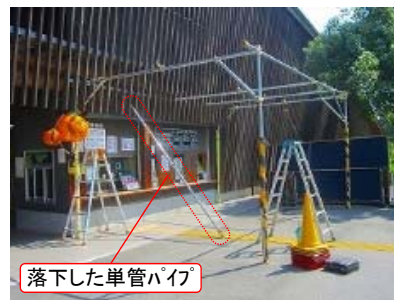
設置状況(事故直後)
