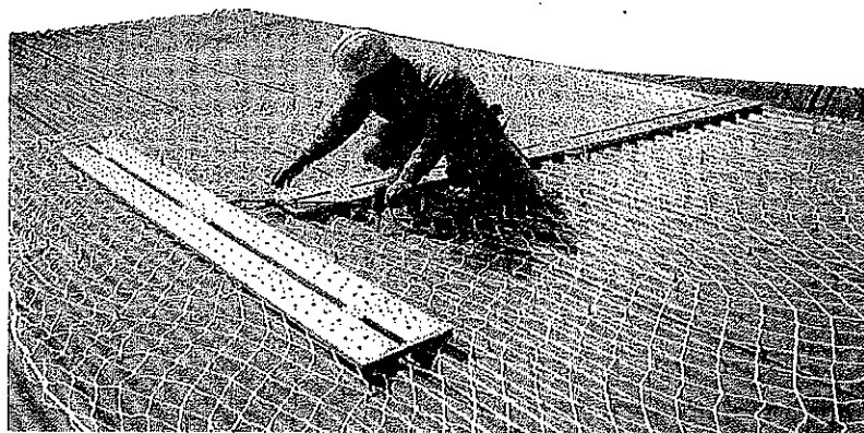
写真 踏み抜き防止用の安全ネットをスレート屋根上に敷き、歩み板を使用した補修工事の例 ((株) A社)
