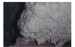
吹付け石綿の例
