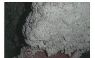
吹付け石綿の例
