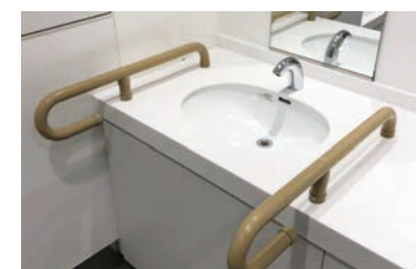
写真② 洗面台の手すり
