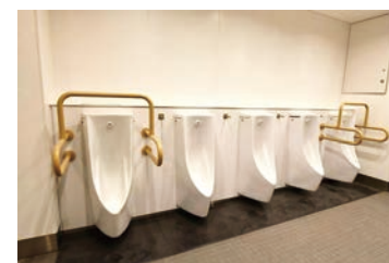
写真① 小便器の手すり
