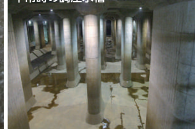
平常時の調圧水槽
