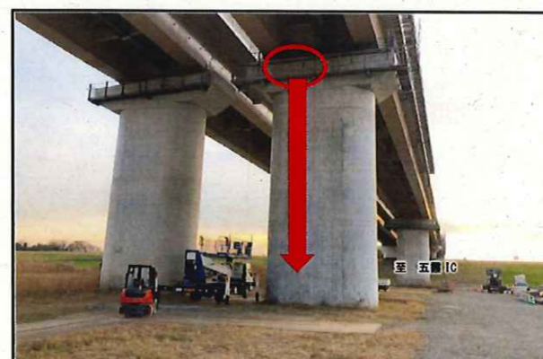
橋梁の下部工検査路設置作業中、作業員1名が転落し死亡が確認された事案
