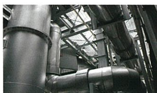
プラント配管
