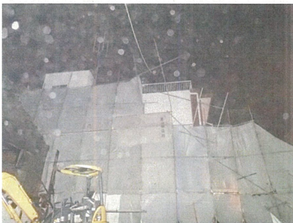
写真1 倒壊した足場の状況
