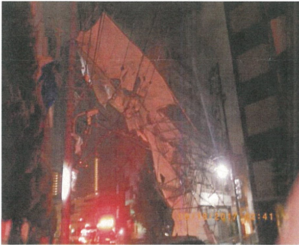
写真1 倒壊した足場の状況 (消防隊現場到着時の状況)
